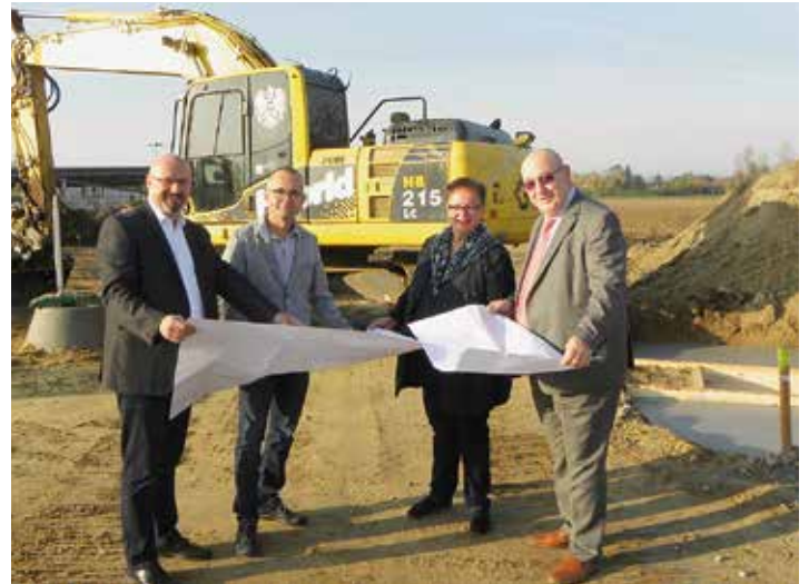
Von links: GV-GF Gerhard Wildpert, Bgm. Martin Leuthner, Bgmin. Lieselotte Golda und Bgm. Anton Pfeifer bei der Besichtigung der Baustelle im GV-Sammelzentrum Ost in Walkersdorf
